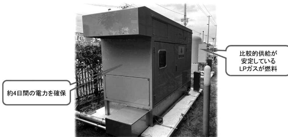
図1. 非常用発電装置
